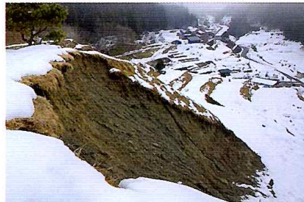
崩落した爪痕が残る棚田(2020年12月29日撮影)
