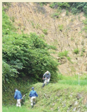
2019年の台風による崩落箇所
